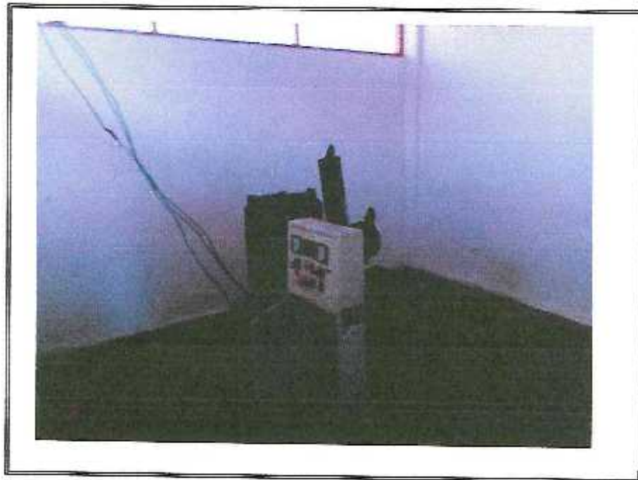
FOTO N° 06, SE MUESTRA AL GENERADOS DE LUZ EN CASA DE FUERZA.
